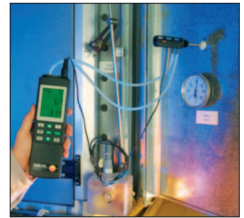
Mesure tube de Pitot sur une évacuation d'air
