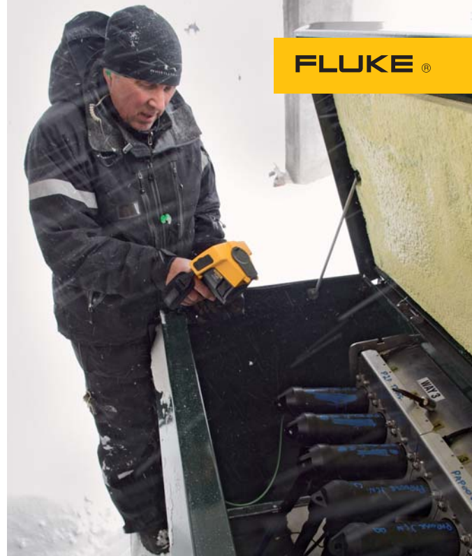
Les caméras infrarouges Fluke s'adaptent parfaitement aux conditions climatiques rigoureuses de la station de ski Whistler, dans l'ouest du Canada.
